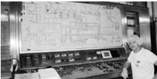
Die Schaltzentrale in der Säntis Käserei Linden
