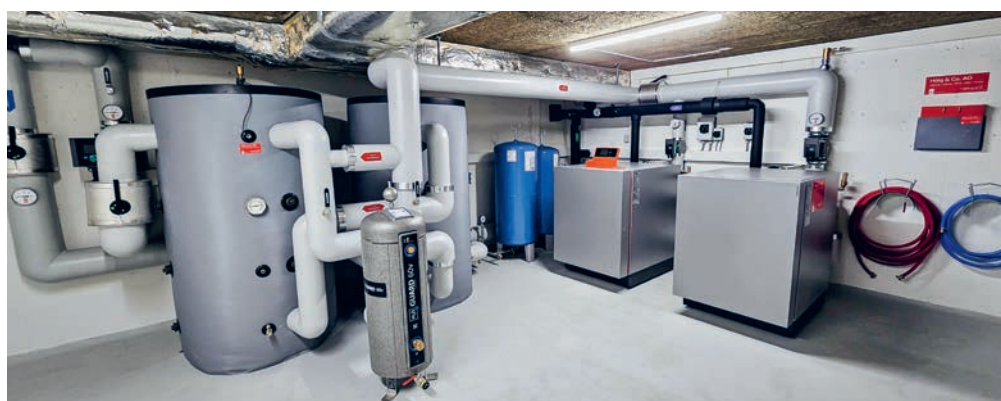
Neu: Raum mit den Wärmepumpen und Warmwasserspeichern.
