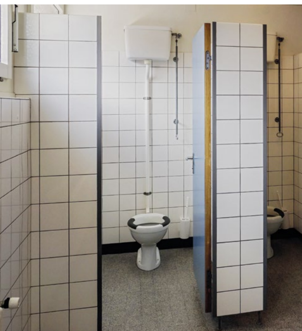
Die sanierungsbedürftigen sanitären Anlagen sind ein Beispiel dafür, dass sich die Anlage in weiten Teilen im damaligen Originalzustand befindet.
