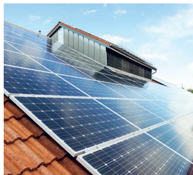
Photovoltaikanlage auf dem Werkhofdach.
