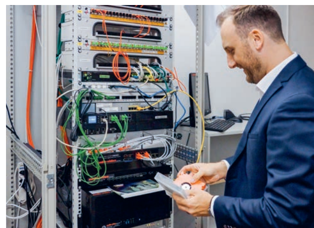
Die Serveranlage im Keller des Gemeindehauses hat gemäss Florian Hafner ihren Lebenszyklus erreicht.
